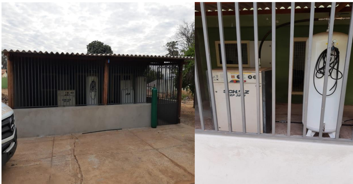
IMAGEM 25. USINA DE FORNECIMENTO DE OXIGÊNIO
